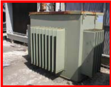
58327 Westinghouse, 500 kva, 13,200 volts entrada, 277 volts salida, salida 3 fases
